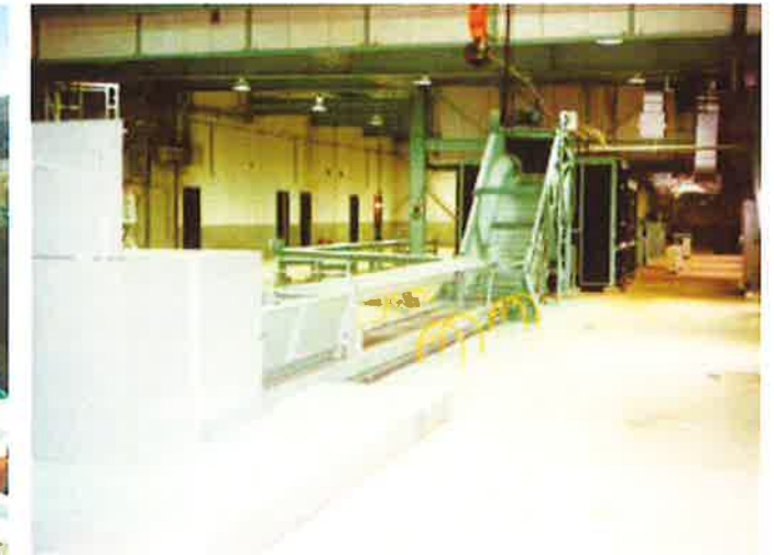
不燃物処理資源化設備
