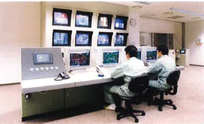
中央制御室 溶融炉や各設備の運転・制御・監視を、ここで集中的に行います。
